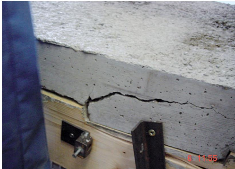
Abb. 4.6 Rissbildung beim Druckversagen der Kervenflanke im Beton
