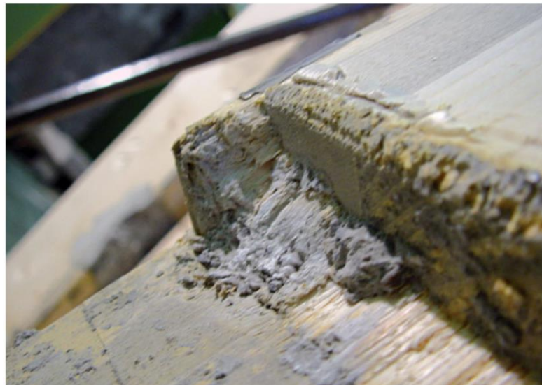
Abb. 4.8 Druckversagen des Holzes in Faserlängsrichtung an der Kervenflanke
