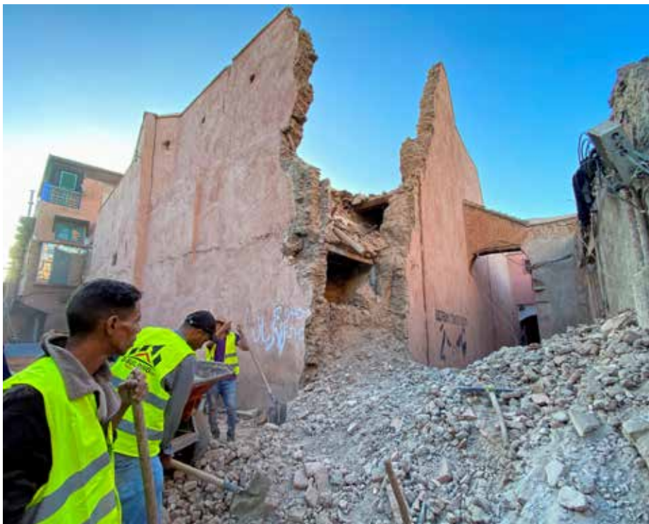
Fig. 2.3 Rotura de un edificio por la esquina debido al terremoto en Marruecos el pasado día 8 de septiembre de 2023. (Fotografía de Abdelhak Balhak para Reuters)
